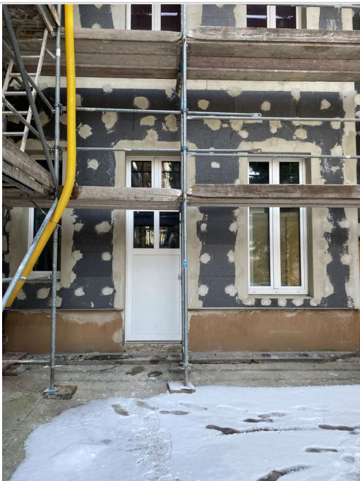
Hofbereich-Einheit von hinten
